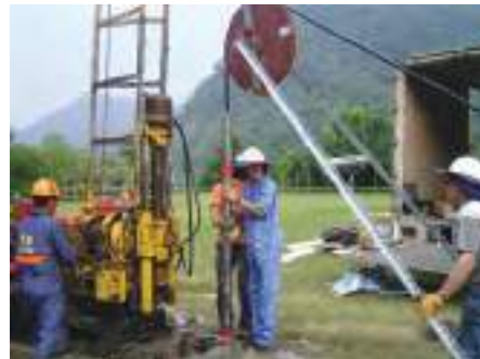
井下地變儀安裝
